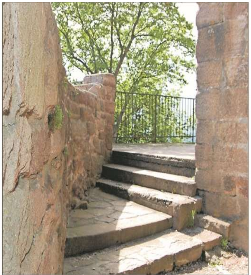
Wohin führt der Weg? Bei der Sanierung der Yburg gibt es noch viele Fragezeichen – dennoch gibt es erste Bewegungen.
